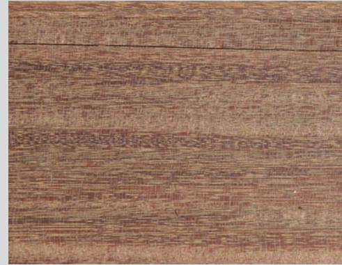
Risse, fein, Oberfläche
