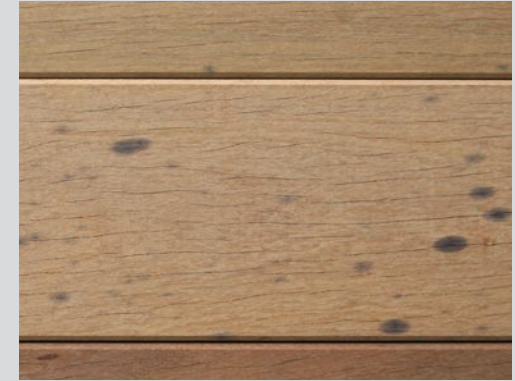
Risse, fein, Oberfläche
